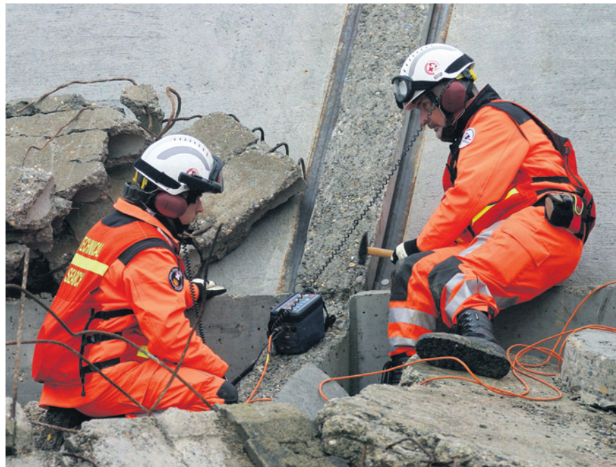
Die mit dem Hammer ausgeführten Klopfschläge werden über die Statik des Gebäudes ins Innere des Schadenplatzes übertragen. Die REDOG-Mitglieder hoffen, über die hochempfindlichen Mikrofone des akustischen Ortungsgerätes, ebenfalls Klopfschläge von Verschütteten empfangen zu können.
