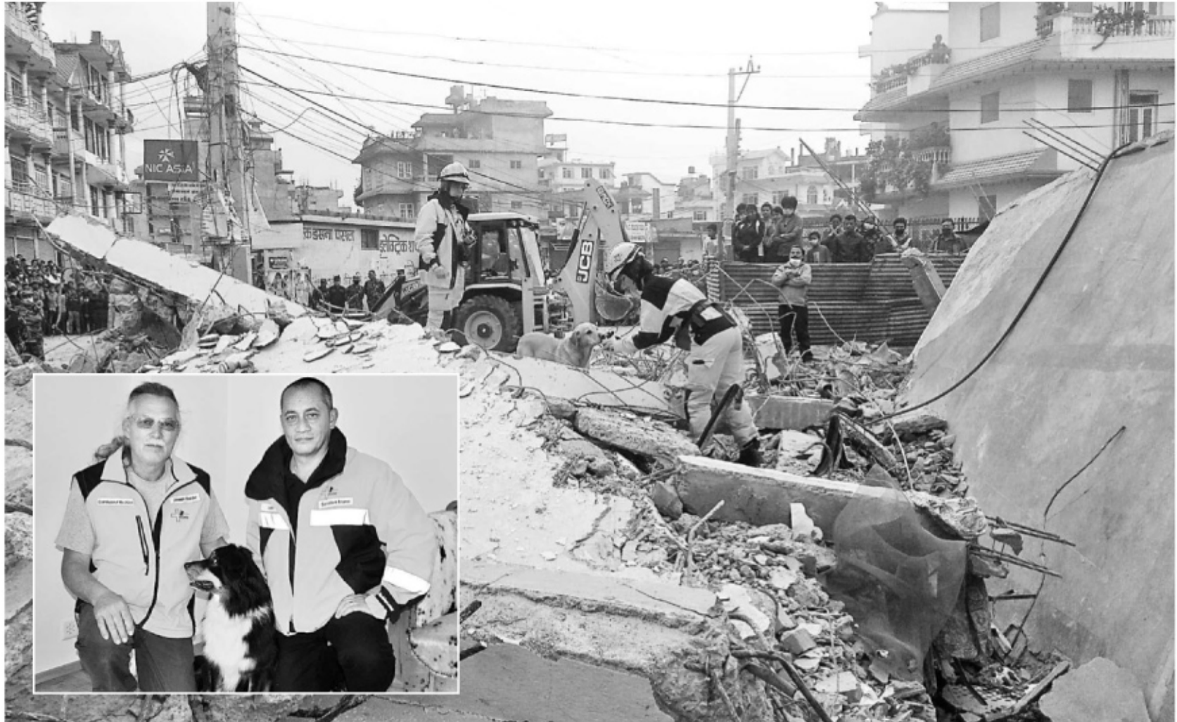
Bild der Zerstörung. Das Schweizer REDOG-Team sucht in der Trümmerwüste nach Verschütteten. Kleines Bild: Salvatore Miano (rechts) mit einem – in Nepal nicht anwesenden – Suchhundeführer.
